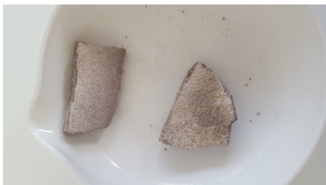
Imagen 2. Incrustación de carbonato cálcico encontrada en un condensador evaporativo
